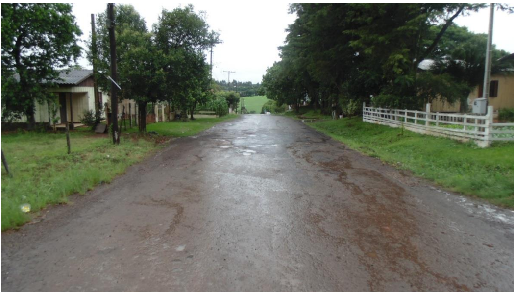
Foto 03: Rua Amazonas, trecho entre a Rua Ceará e Av. Belém. Passeios não executados, via com revestimento primário e resíduo asfáltico. Passeios 2,50m e pista de rolamento com 11m – pavimentação asfáltica.
