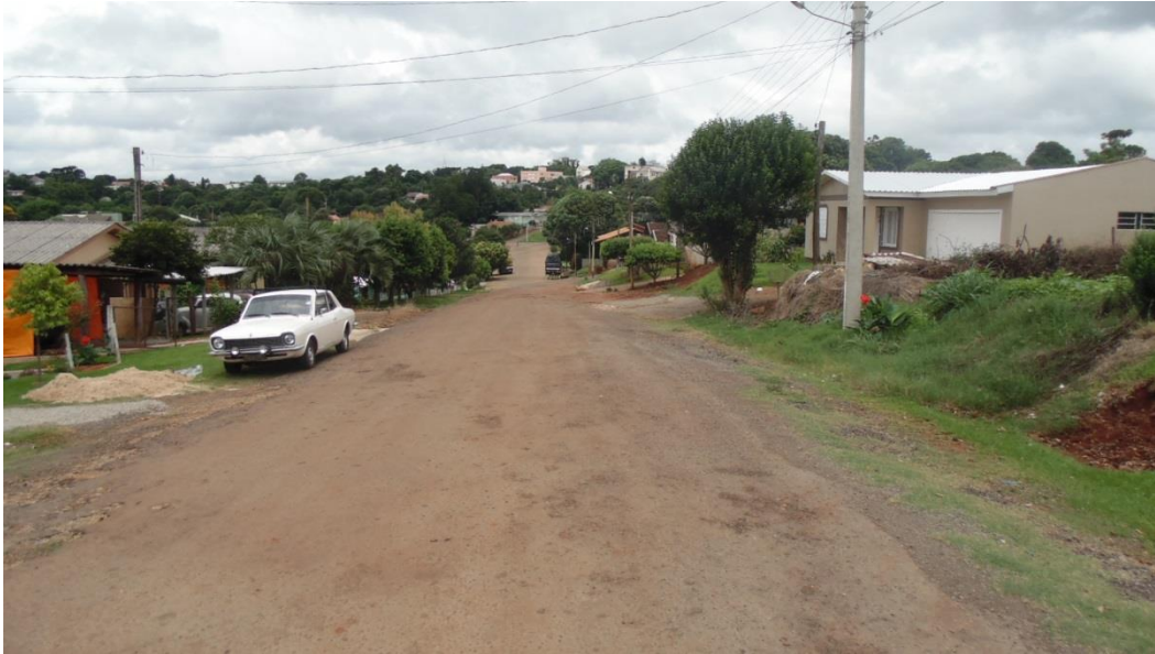
Foto 02: Av. Belém, trecho entre a Av. Brasília e Rua Pernambuco. Passeios não executados, via com revestimento primário e resíduo asfáltico. Passeios 3m e pista de rolamento com 14m – pavimentação asfáltica.
