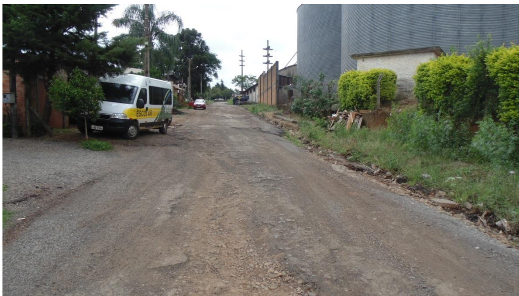
Foto 08: Rua Jaime Viau, trecho entre a Av. Stara e Av. Guilherme Augustin. Passeios não executados, via com revestimento primário e resíduo asfáltico. Passeios 2,50m e pista de rolamento com 8m – pavimentação asfáltica.
