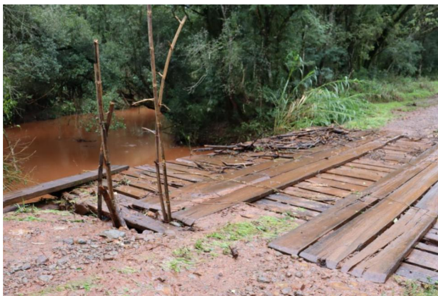
Perda de solo. Vistoria in loco 13/07/2023.
