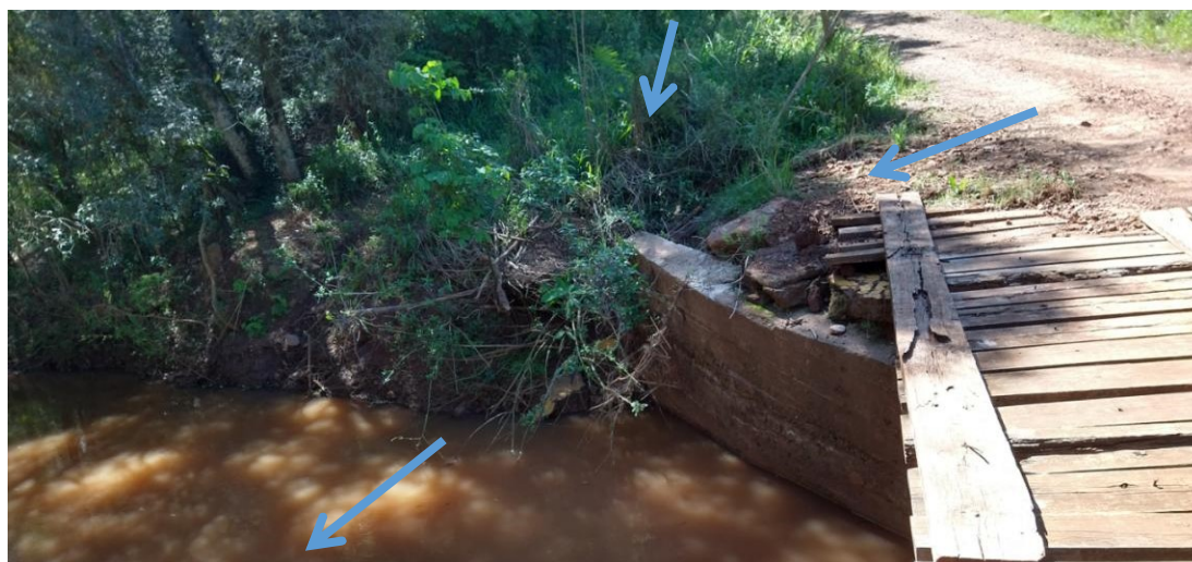
Erosão da face noroeste. Vistoria in loco 29/09/2023.
