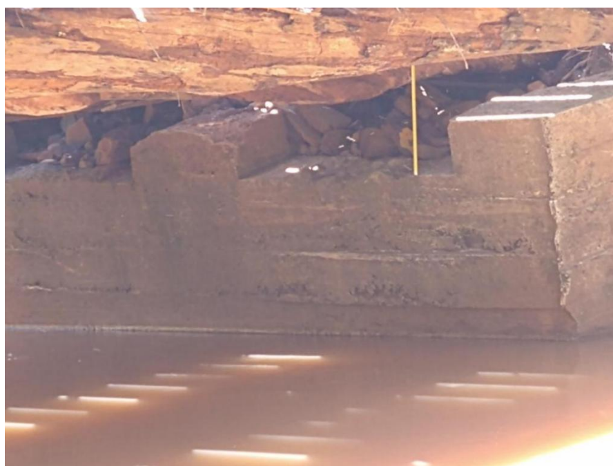
Cabeceira norte, face leste. Vistoria in loco 28/09/2023.
