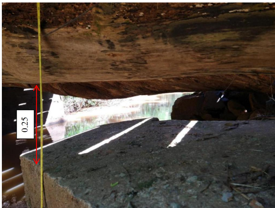
Cabeceira norte, face leste. Vistoria in loco 28/09/2023.
