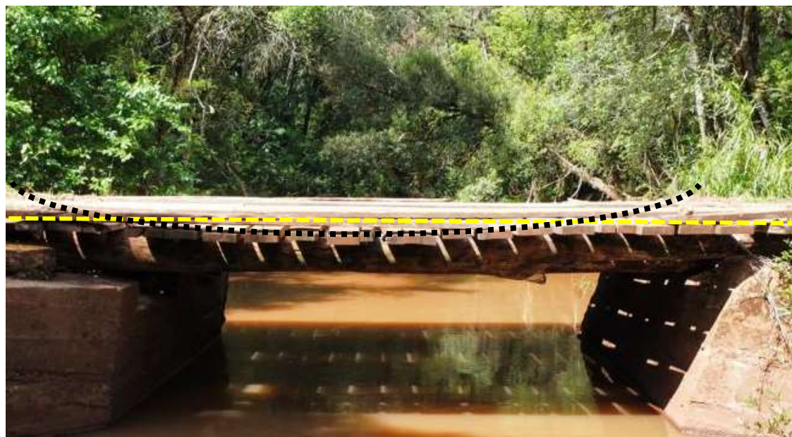
Deformação do tabuleiro do oeste para o leste. Vistoria in loco 28/09/2023.
