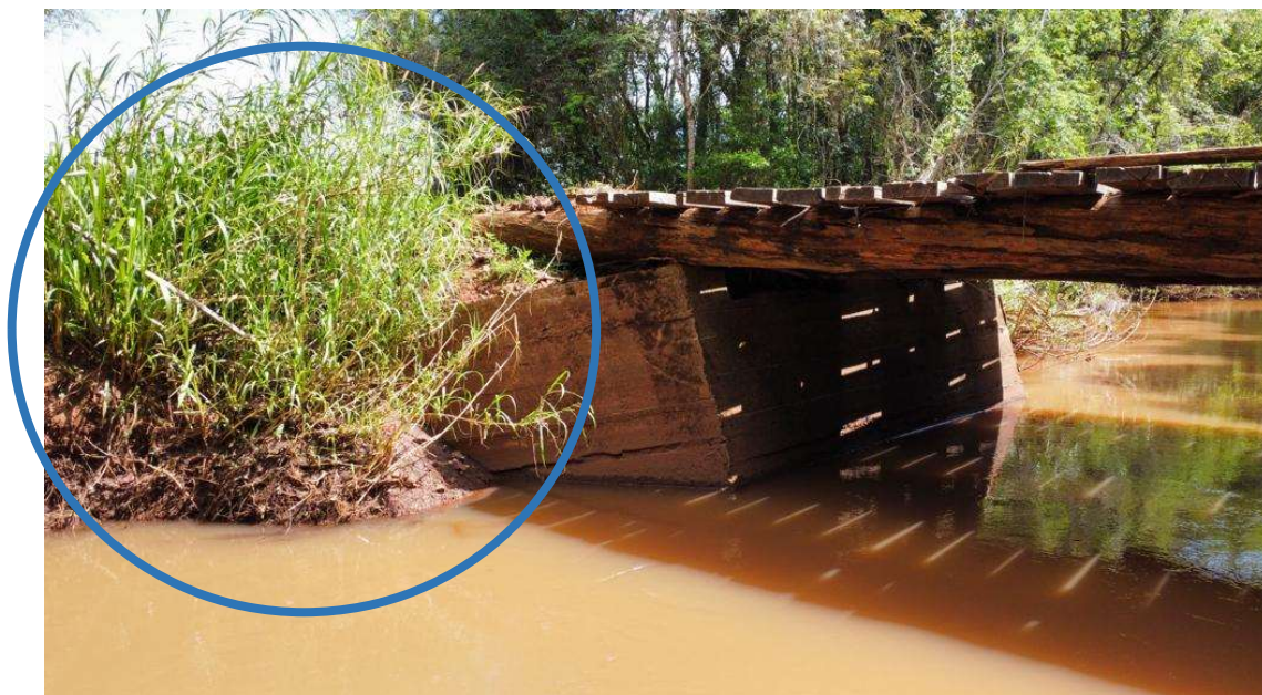
Cabeceira sul com drone no leste voltado para o sudoeste. Acúmulo de solo deslocado. Vistoria in loco 29/09/2023.
